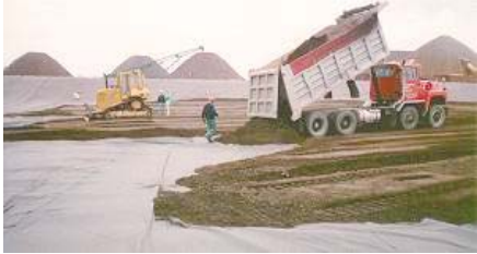
Celda de máxima seguridad, doble impermeabilidad
