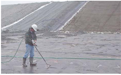
Prospección a chorro de agua: inspección de la superficie de la geomembrana antes del recubrimiento
